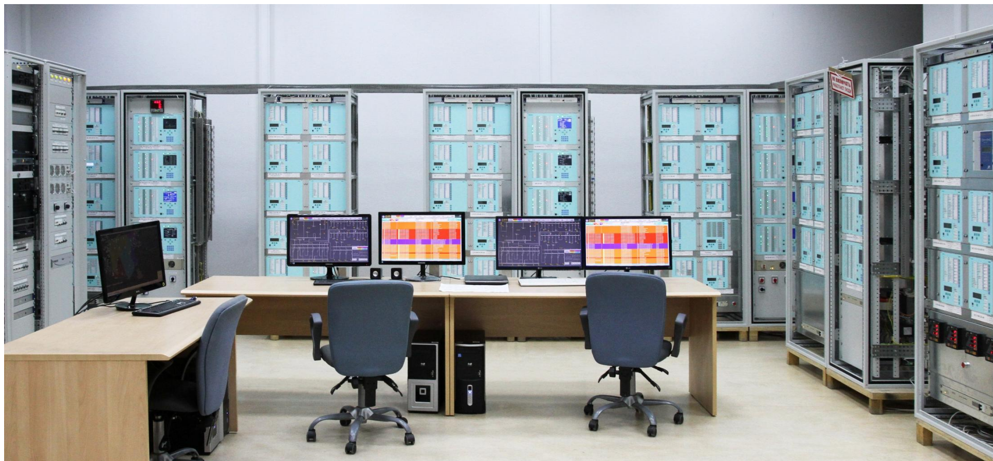
Рисунок 1 – Испытательный полигон ПТК АСУ ТП EVICON
